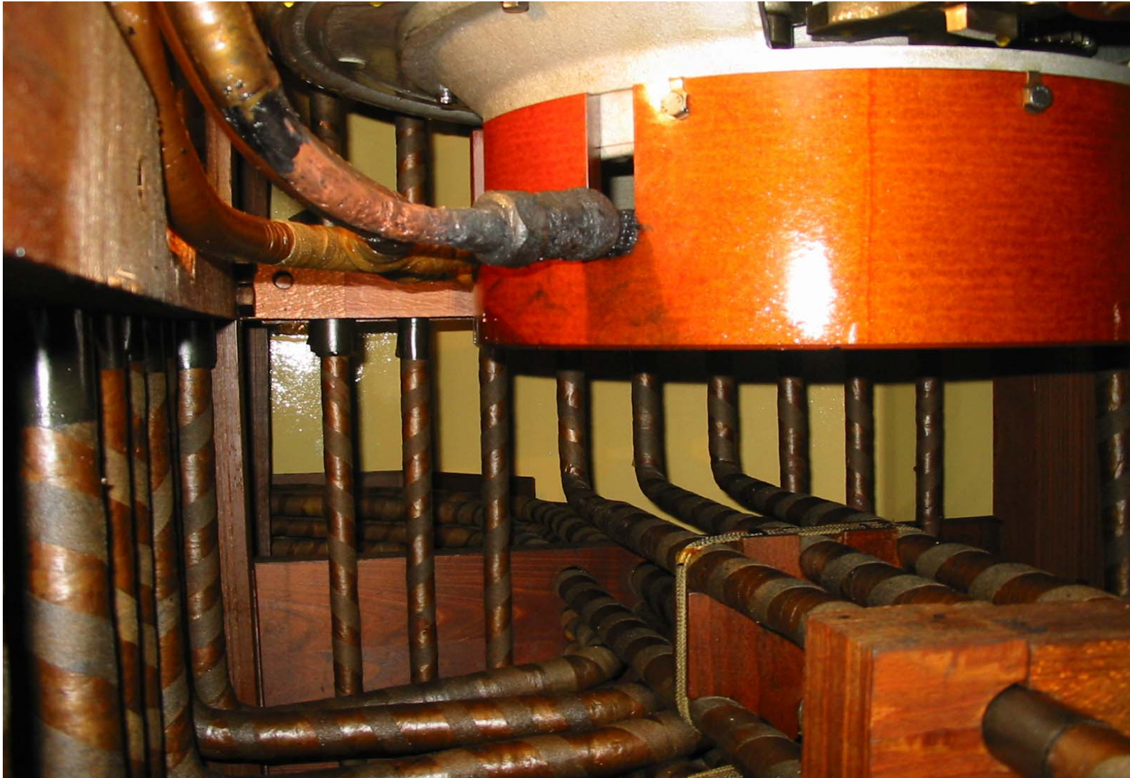
Meghibásodott szigetelt (kiégett) vezeték (HGA termikus hibát jelzett)
